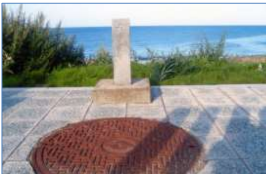
このマンホールから樺太へケーブルが伸びていました
